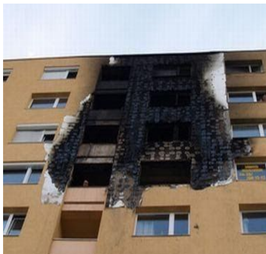
Rys. 8.3. Widok budynku po pożarze (przykład rozprzestrzeniania się ognia, do którego przyczyniło się najprawdopodobniej nieprawidłowe przyklejanie płyt styropianowych)
