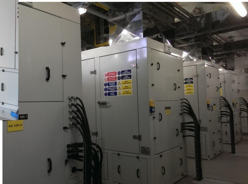
Oczyszczalnia Ścieków Siedlce (paliwo biogaz i gaz ziemny) łącznie 840 kWe / 1150 kWt
