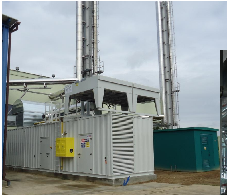
Szpital Radom(gaz ziemny) łącznie 1166 kWe / 1150 kWt
