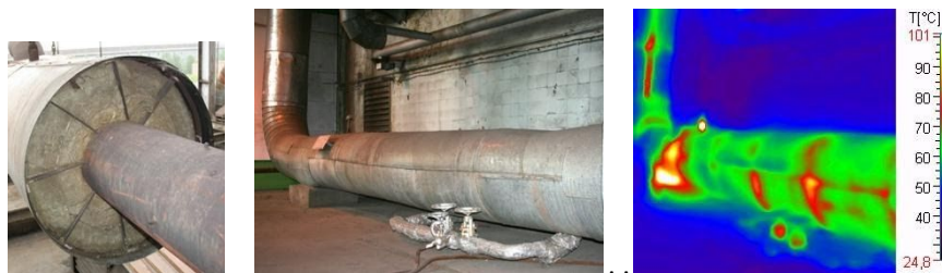
Rys. 3.3. Mostek termiczny niewidoczny: konstrukcja wsporcza płaszczu ochronnego (zdjęcia i termogram; dla płaszczu ochronnego t_{max} = 95,2 \text{ } ^\circ\text{C} )
