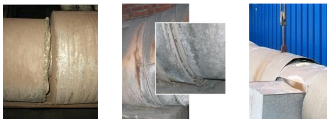
Rys. 3.7. Mostki termiczne montażowe rurociągu parowego: niestaranne założenie elementów izolacji
