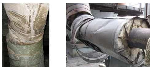
Rys. 3.8. Mostki termiczne eksploatacyjne: deformacje płaszcza ochronnego i jego konstrukcji wsporczej
