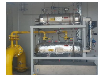
monitoring parametrów instalacji
